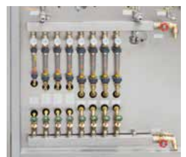
Rozdzielanie wody chłodzącej
