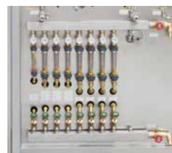
Rozdzielanie wody chłodzącej
